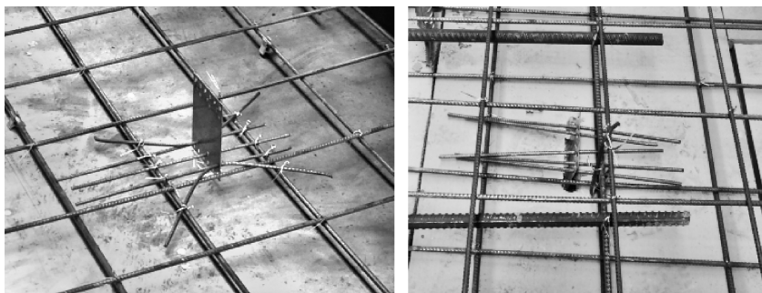
图 1-22 穿孔锚固筋未放置于钢筋网外侧
